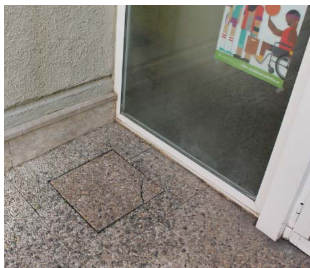
Arqueta eléctrica. Junto fachada, zona de vestíbulo.
