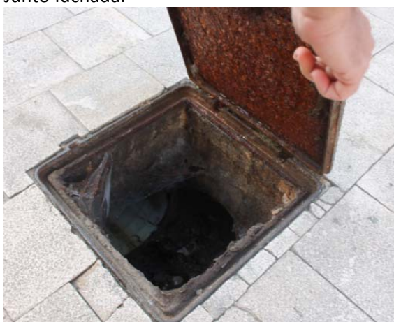
Arqueta saneamiento en acera.
