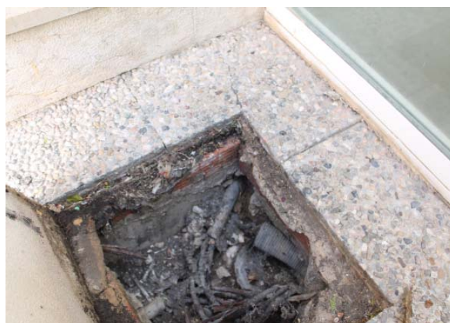
Arqueta eléctrica. Junto fachada, zona de vestíbulo.
