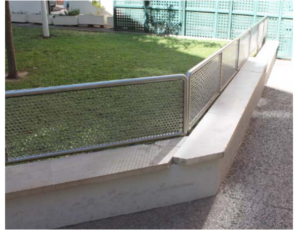
Detalle de bancada de obra y mármol. Zona de retirada para paso de vehículos.
