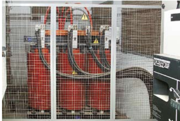
Centro de Transformación.
