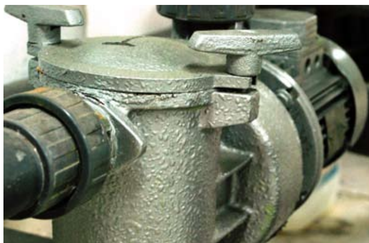
Grupo bombeo piscina.
